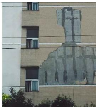
外壁に脱落が生じている
