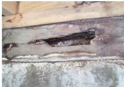
土台に蟻害が発生している
