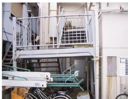
屋外階段が傾斜している
