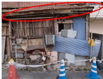
軒に不陸、剥離が生じている
