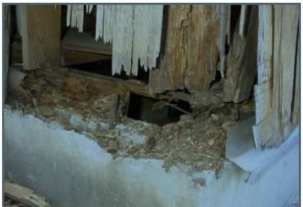
蟻害が発生し欠損している
