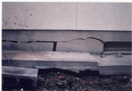
基礎が大きく破損している
