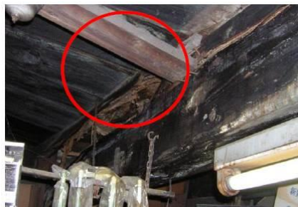
はりの欠損、腐食などが発生している
