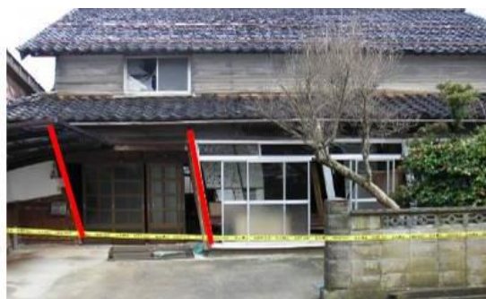
1階部分が傾斜している
