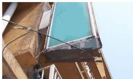
底板に腐食が生じている
