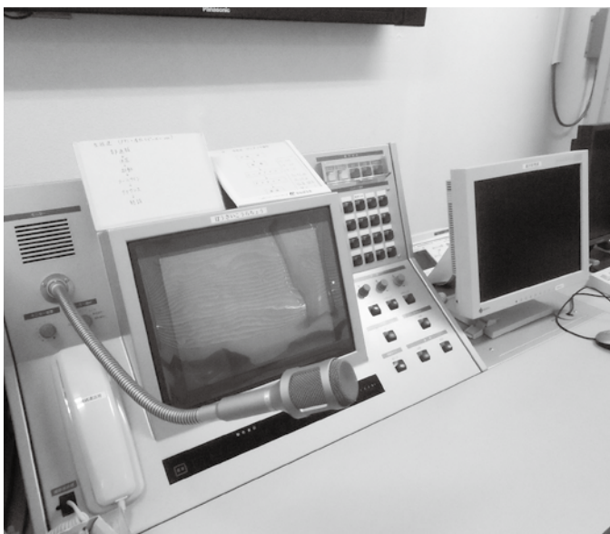
防災無線の放送設備
