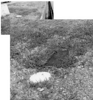
町有地に設置の公共マスと水道メーター
