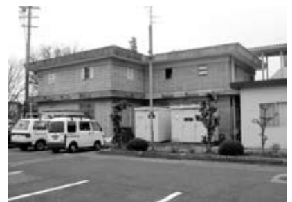
耐震が危ぶまれる役場別館
