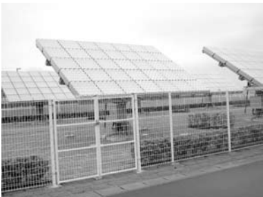
太陽光発電施設
