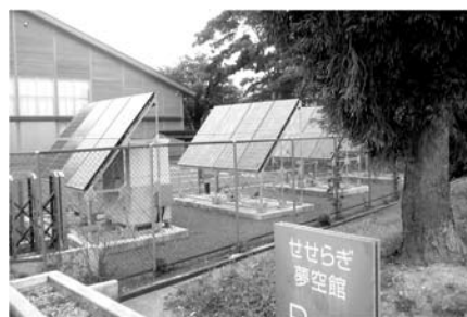
甲良西小学校に設置された太陽光発電
