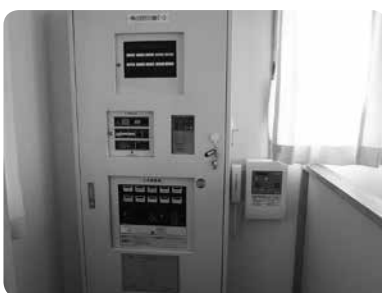
旧給食センター内火災受信機および通報装置
