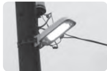
LED化された防犯灯
